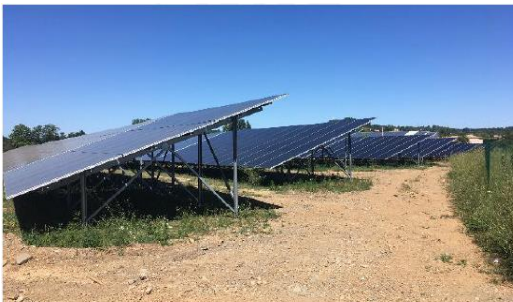
PHOTOGRAPHIE DES STRUCTURES PHOTOVOLTAÏQUES FIXES (SOURCE : GENERALE DU SOLAIRE)
